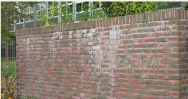
So bitte nicht: Die Oberkante dieser Mauer wurde manuell erstellt. Die Folge: Regenwasser dringt ins Mauerwerk ein und verursacht hässliche Auslaugungen. Mit einer vorgefertigten Mauerwerksabdeckung von Röben wäre das nicht passiert.
