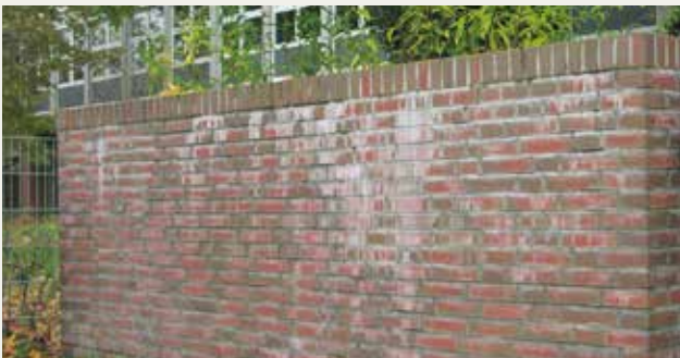
So bitte nicht: Die Oberkante dieser Mauer wurde manuell erstellt. Die Folge: Regenwasser dringt ins Mauerwerk ein und verursacht hässliche Auslaugungen. Mit einer vorgefertigten Mauerwerksabdeckung von Röben wäre das nicht passiert.
