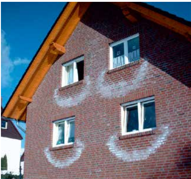
Ausblühungen (hier im Bild die sogenannten „Wassersäcke“), entstanden durch Regenwasser, das durch nicht fachgerecht ausgeführte Fensterbänke in das Mauerwerk eingedrungen ist.
